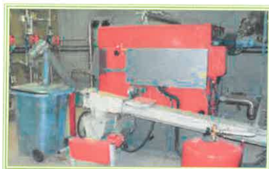
Chaudière bois de la collectivité
